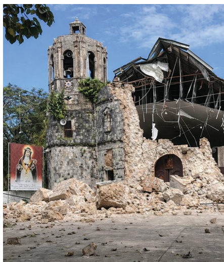
Zniszczona fasada sanktuarium św. Róży z Limy w Cebu po trzęsieniu ziemi, fot. Sanktuarium Archidiecezjalne św. Róży z Limy
